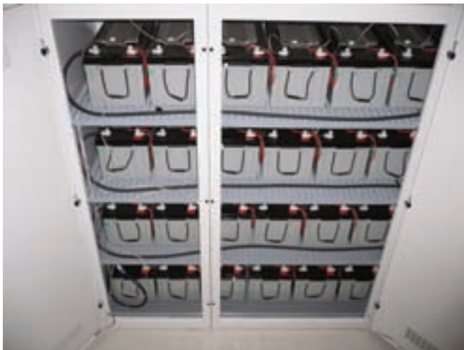
200 Ah-batteries with BACS in Quasar batterie cabinett
